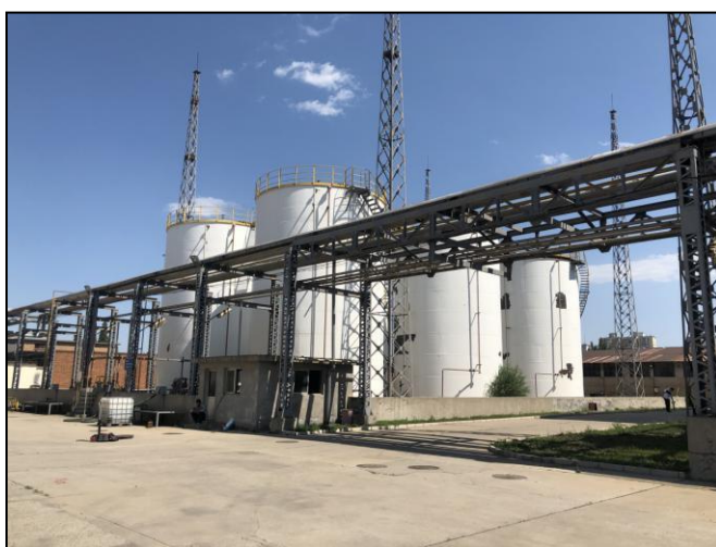
照片 7 乙二醇罐区
