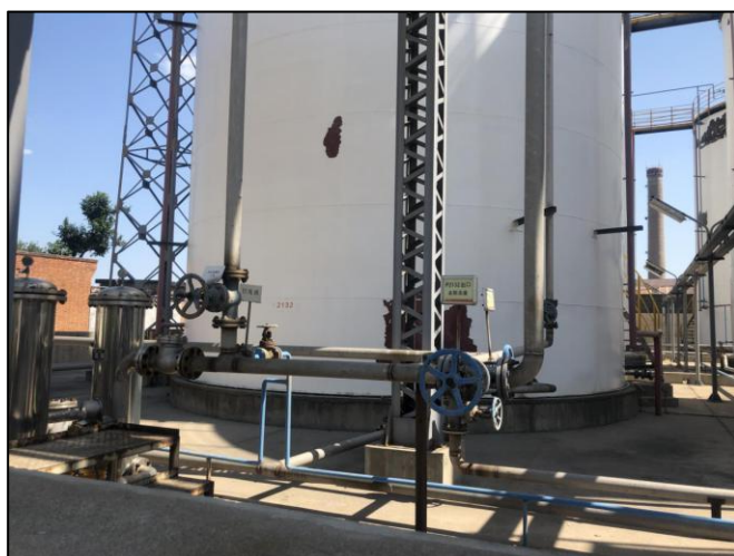
照片 15 乙二醇在用储罐
