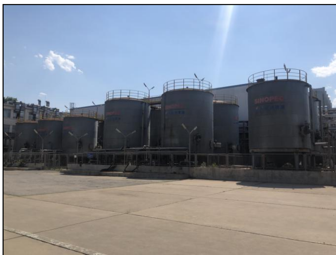
照片 11 原添加剂罐区
